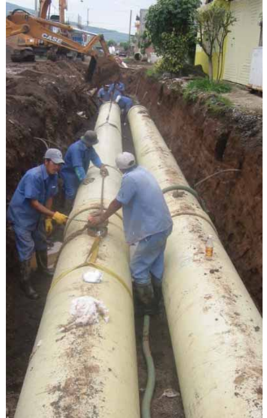
Instalación a base de polipastos
