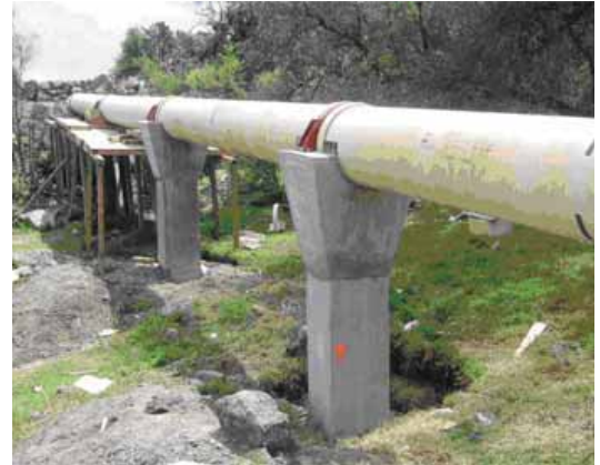
Instalación aérea en DN 600 mm
